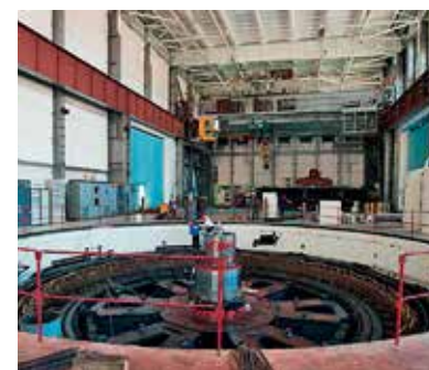
Миатлинская ГЭС (гидрогенератор типа ГСВ-1230- 140-48 УХЛ 4)
