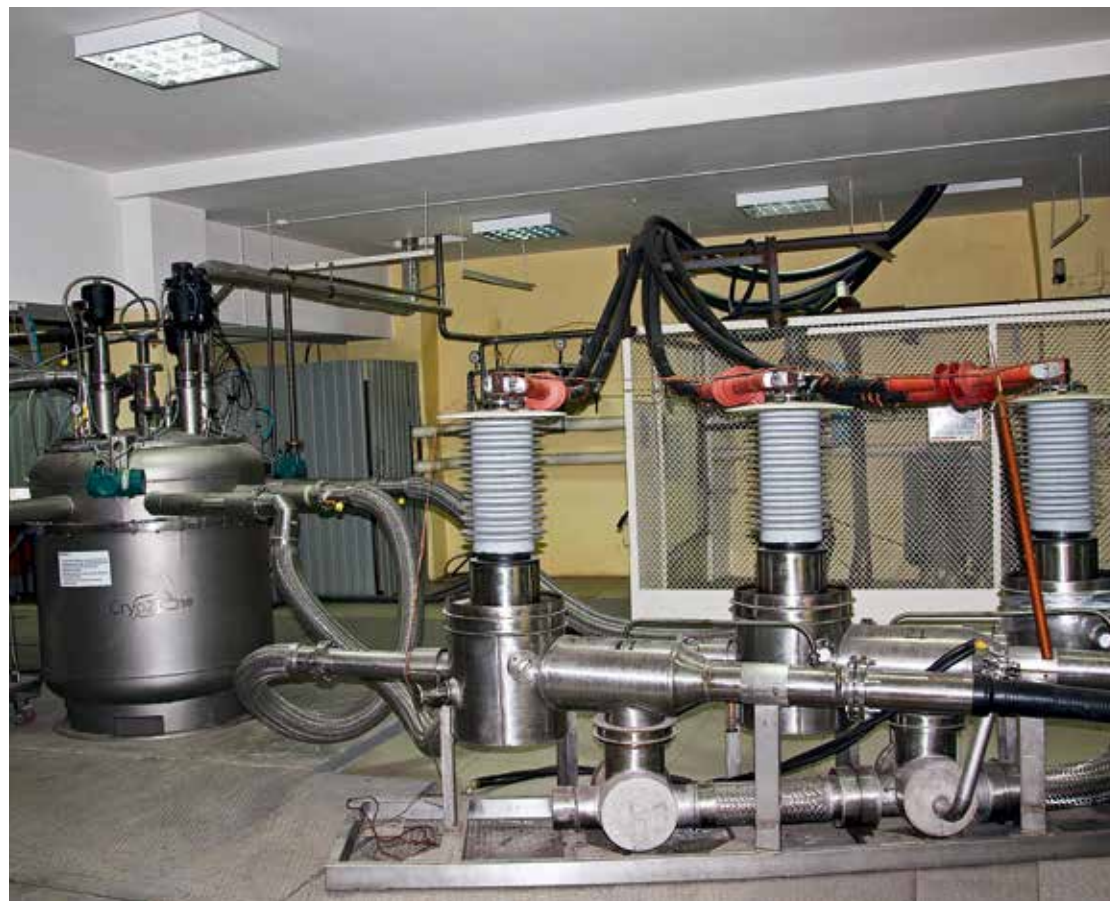
ОАО «НТЦ ФСК ЕЭС» обладает современным полигоном по испытаниям ВТСП оборудования под нагрузкой
