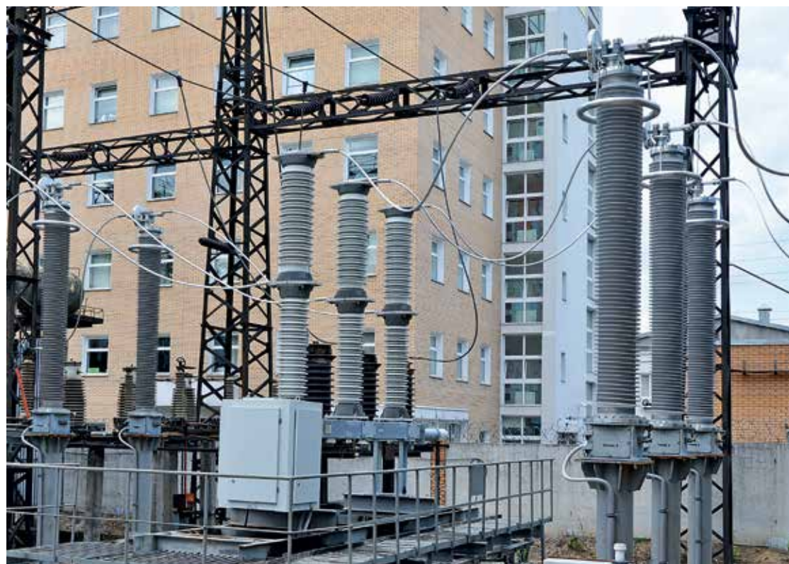
Опытный полигон «Цифровая подстанция» на базе ОАО «НТЦ ФСК ЕЭС»
